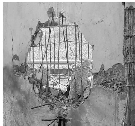
Dinamite. Com a explosão, um buraco foi aberto no muro da penitenciária
