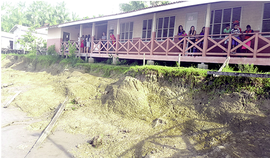
Fenômeno. Escola ameaçada de desabamento por causa da erosão que avança desenfreada.
