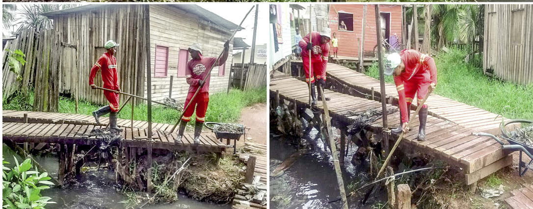
Assoreamento e lixo. Trabalho revela situação crítica de um dos canais mais importantes que cortam a capital.
